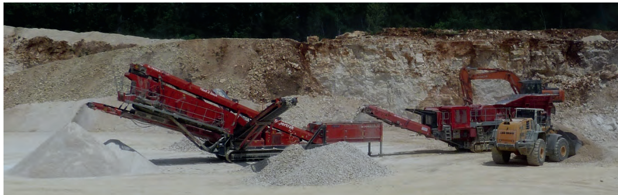
◀ Fonctionnement général de l'installation mobile type mise en œuvre sur le site
